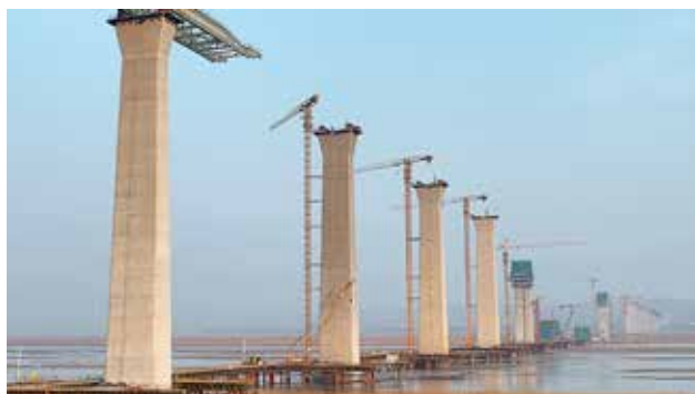
2022 年 8 月 12 日，G3511 荷宝线临猗黄河大桥建设项目陕西境内桥墩、梁板架设
