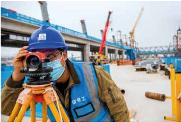
2022年11月，西安咸阳国际机场三期扩建工程施工现场 (西部机场集团)
