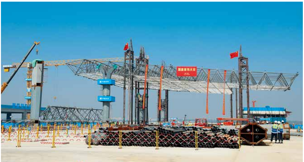
2022年9月29日，西安咸阳国际机场三期扩建工程T5航站楼首根金属屋盖钢结构完成吊装 (民航西北地区管理局)
