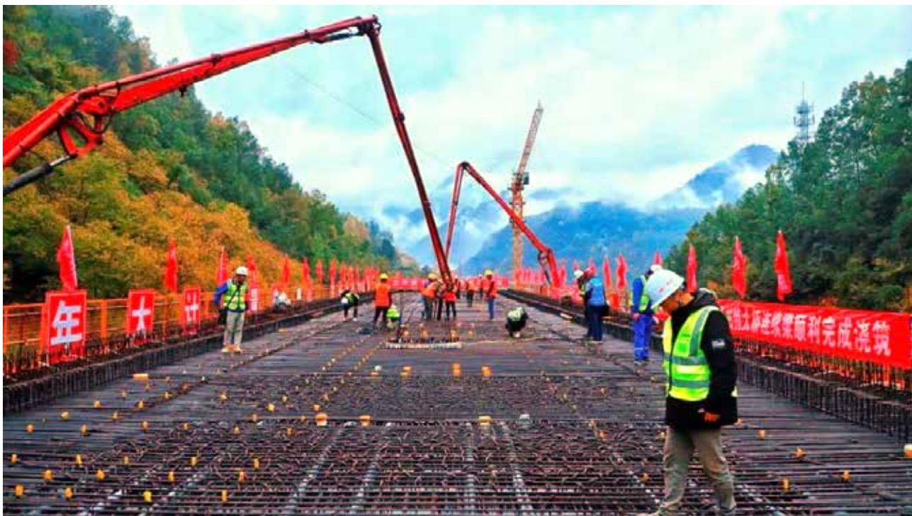
2022年10月29日，西康高铁镇安西站1号特大桥施工现场（中铁西安局集团）
