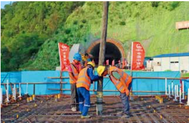
2022年8月27日，西康高铁付家河大桥1#墩上部连续梁“0号块”顺利浇筑完成，这是西康高铁全线首联连续梁启动浇筑施工，标志着西康高铁桥梁工程建设进入新阶段（中铁西安局集团）
