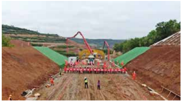
2022年4月16日，西延高铁任家台一号大桥西安台至1号墩间箱梁顺利完成浇筑，这是西延高铁全线完成的首孔箱梁（中铁西安局集团）
