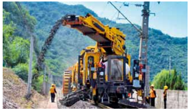
2018 年 9 月，中铁西安局集团工务机械段在管内宁西、宝成、包西等线路开展大修施工，图为在宝成线黄牛铺至红花铺区间进行线路边坡清筛作业
