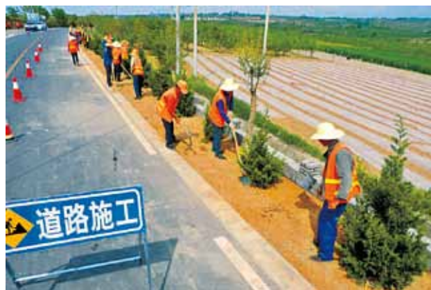
2018年4月5日至7日，清明节假期，淳化公路局主动排查211国道淳化段地质灾害易发、高危边坡、过境路段和马家、润镇两架沟不稳定边坡路段隐患，发现问题，立即整改，确保国省干线公路安全畅通 (郭忠凯)
