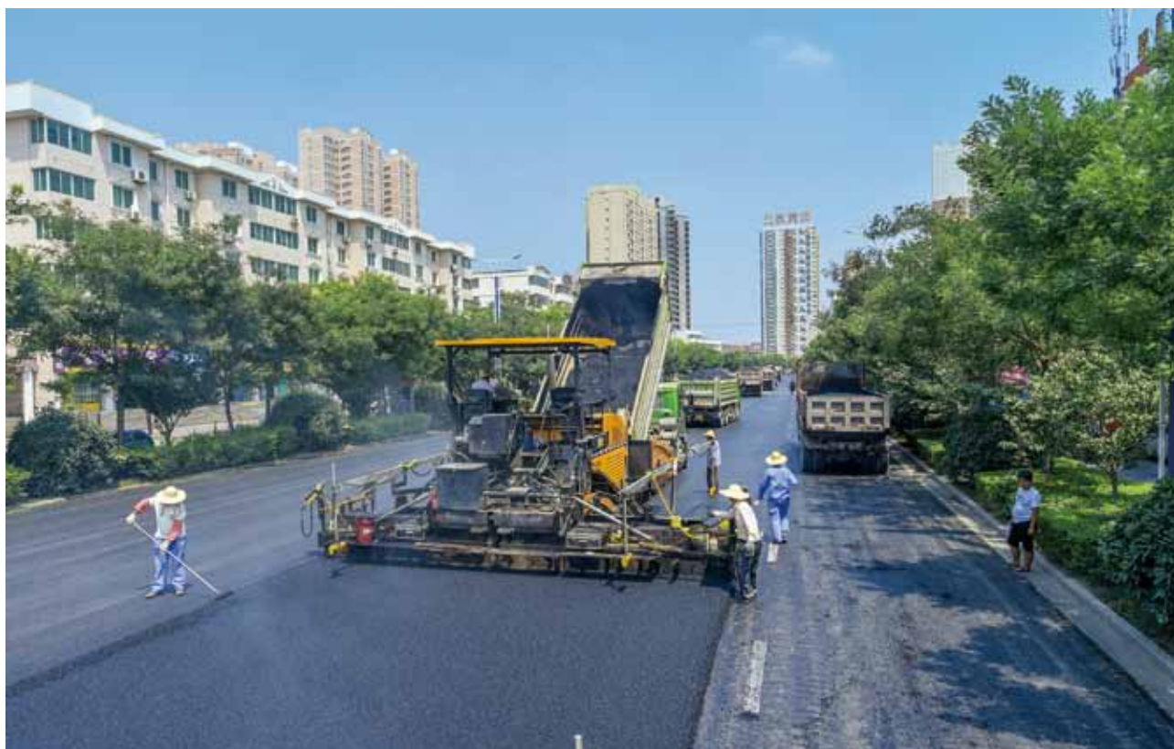
2018 年 7 月 23 日，104 省道兴平城区过境段（金城路东段）改建工程金城路沥青上面层铺设现场（王婷）
